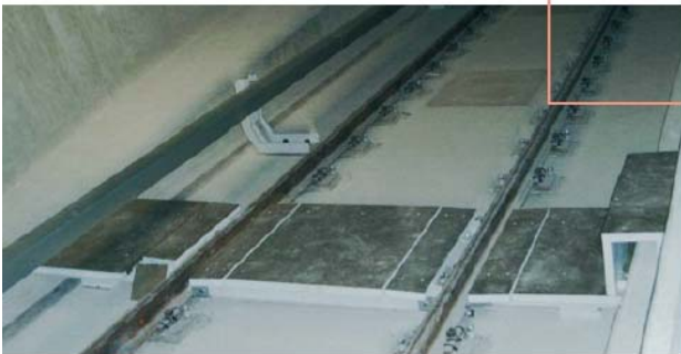
Voies de maintenance Métro de Fürth
