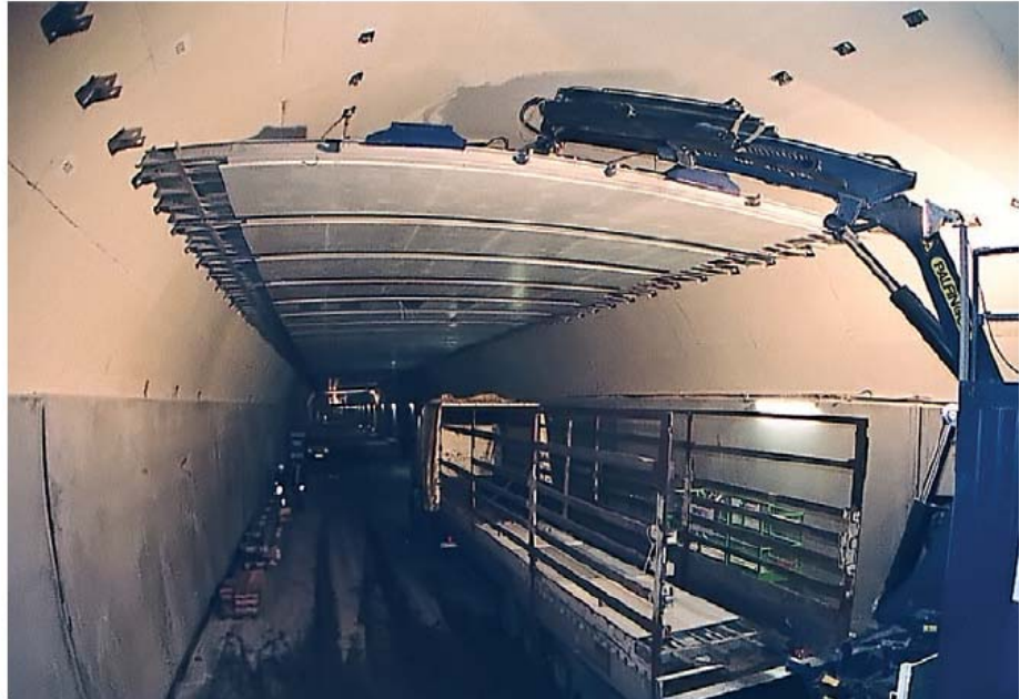
Plafond de désenfumage
