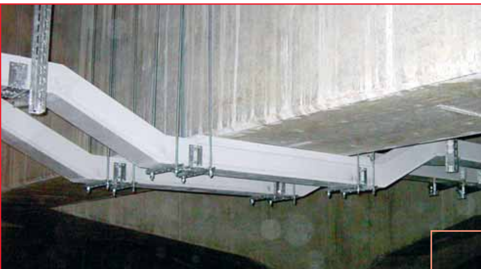
Conduits de câbles AESTUVER suspendus
