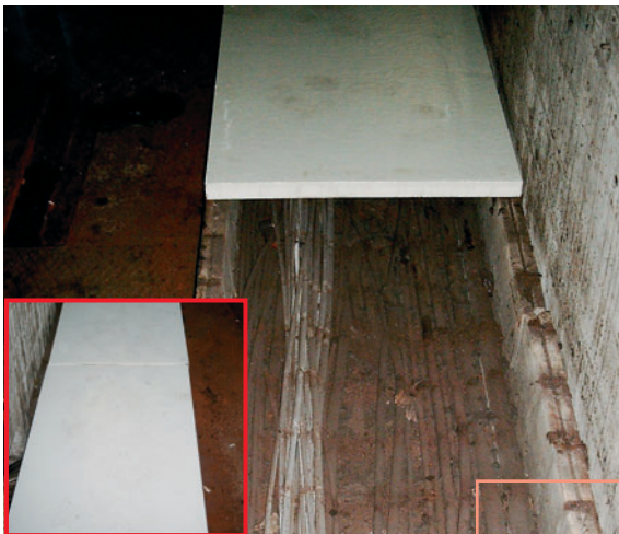
Betontrogabdeckung, U-Bahn Nürnberg
